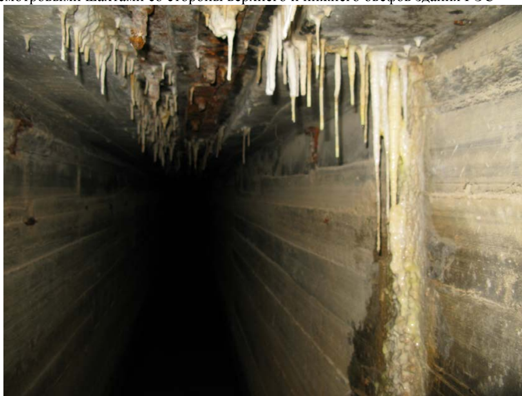
Рисунок 5.2 - Фильтрация воды с выносом окиси гидрата кальция через швы бетонирования и из-под потолочного уплотнения деформационного шва в соединительном коридоре между смотровыми шахтами верхнего и нижнего бьефов
