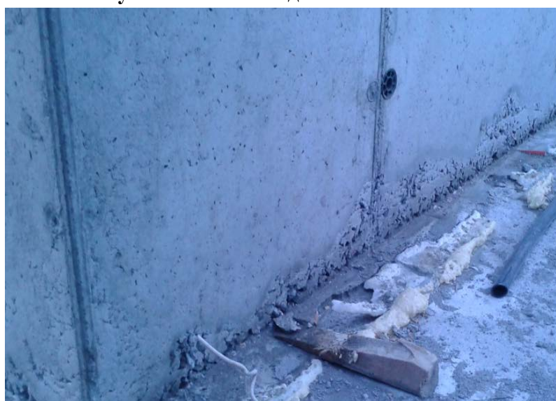
Рисунок 7.1.4 - Непровибрированный участок бетона (место, где наиболее вероятны протечки воды)
