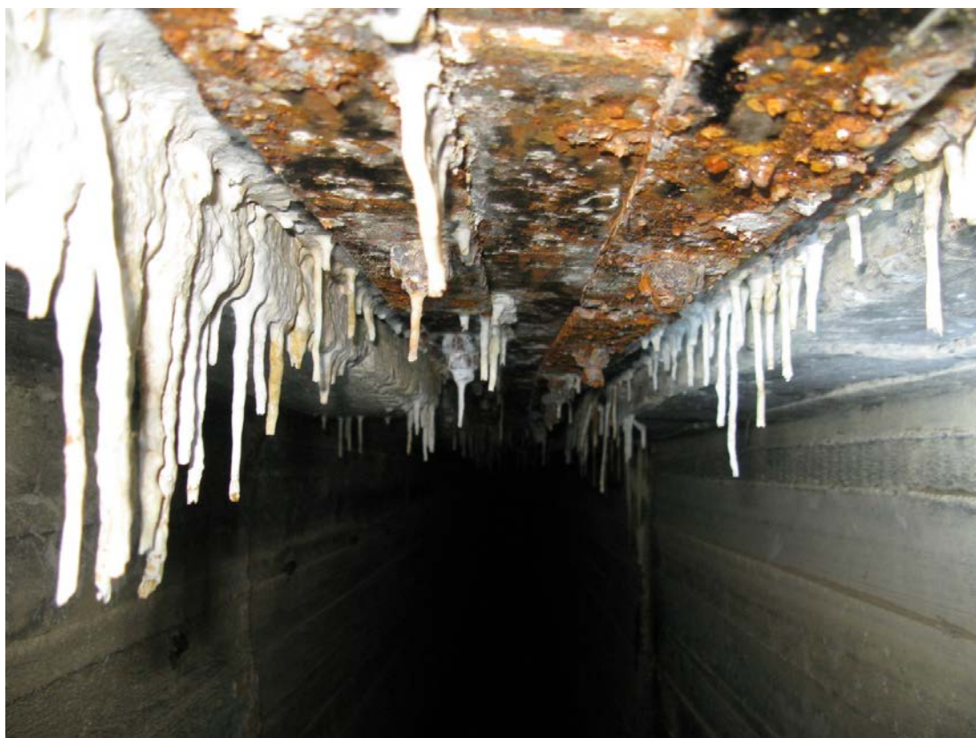
Рисунок 5.1 - Фильтрация воды через потолочное уплотнение деформационного шва с выносом гидрата окиси кальция и образованием «сталактитов» в соединительном коридоре между смотровыми шахтами со стороны верхнего и нижнего бьефов здания ГЭС
